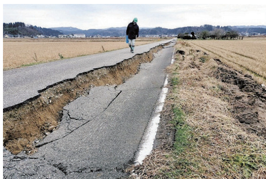
断層により農道の真ん中に亀裂
