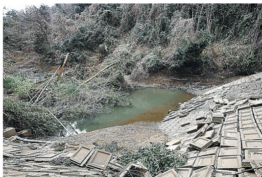
ため池の法面崩壊、樹木や土砂流入
